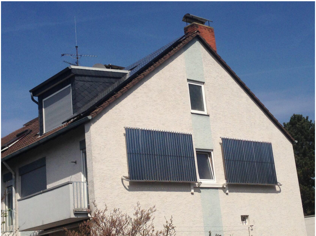
Photovoltaik mit waagrecht angebrachter Solarthermie (Röhrenkollektoren)
