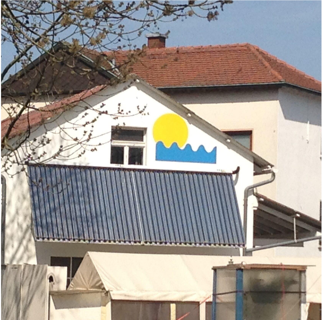
Große Röhren-Solarthermieanlage zur Heizungsunterstützung
